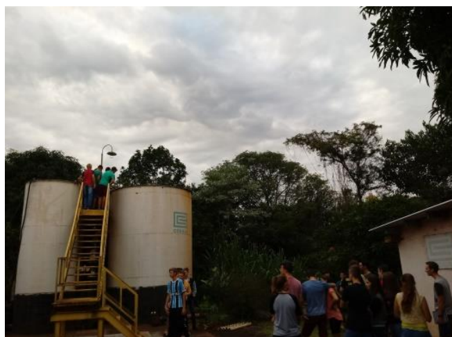
Figura 1- Tanques de filtração Fonte: Os autores (2018).
